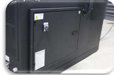
Gizli Elektrik Panosu
