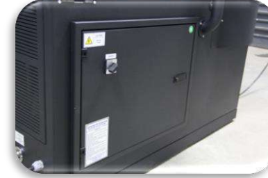
Gizli Elektrik Panosu
