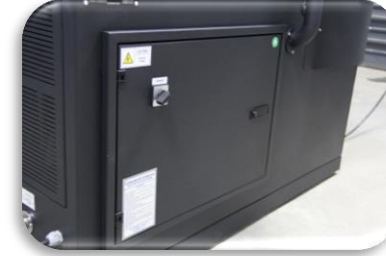
Gizli Elektrik Panosu
