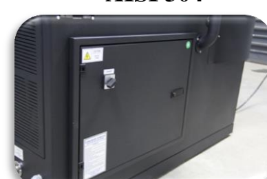
Скрытая электрическая панель
