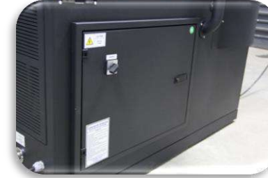
Gizli Elektrik Panosu
