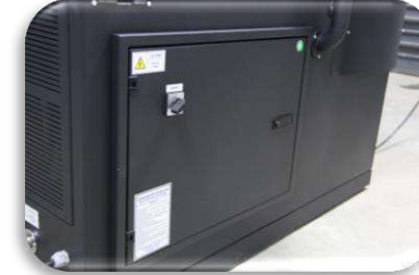
Gizli Elektrik Panosu
