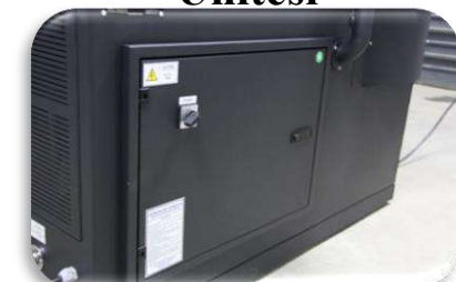
Gizli Elektrik Panosu
