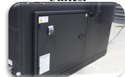
Gizli Elektrik Panosu
