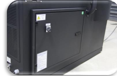
Gizli Elektrik Panosu
