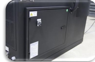
Gizli Elektrik Panosu
